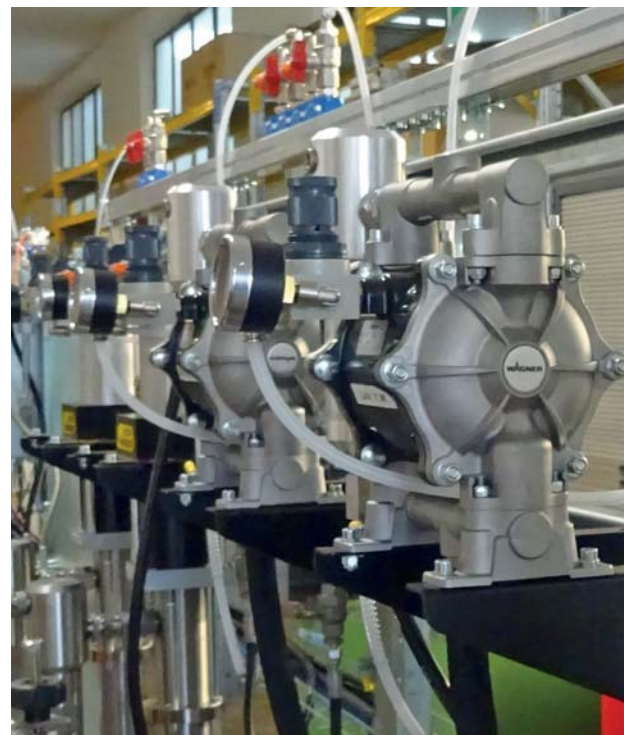
Le pompe a membrana installate da Wagner Italia.
